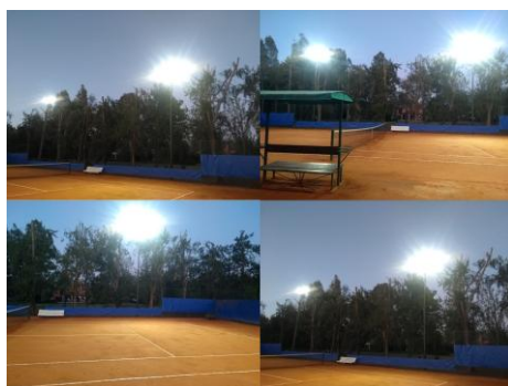
Iluminación de tenis. Vistas del sistema de iluminación.
