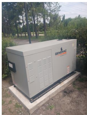
Grupo electrógeno destinado al sector de Guardia.
