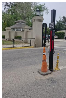
Estación de comunicación y control en el acceso vehicular.
