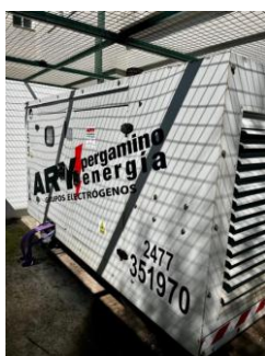
Grupo electrógeno ARI.
