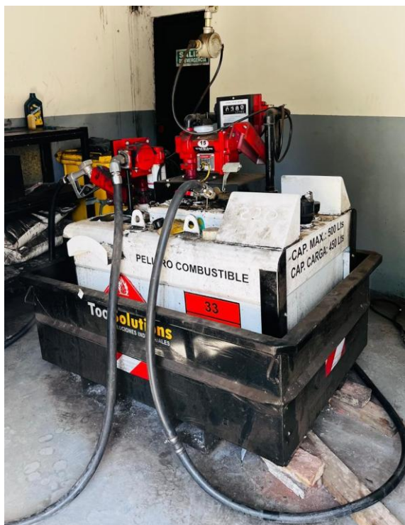
Depósito y módulo de abastecimiento · estado actual.
