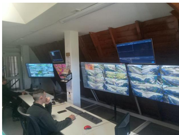
Puesto de trabajo del Centro de Monitoreo.
