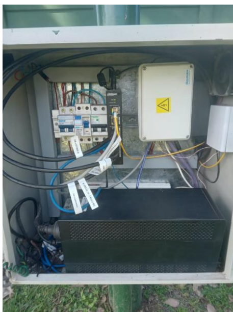
Interior de un gabinete de equipos.
