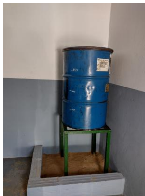
Sector interior con recipiente y contención.
