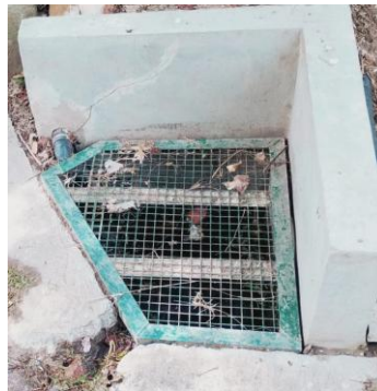
Cámara de impulsión del sector Retamas.
