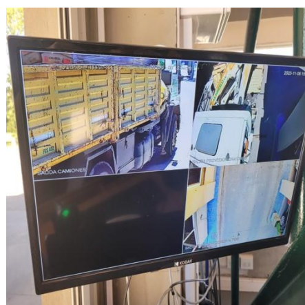
Visualización de los sectores de carga y baúles desde el puesto de control.
