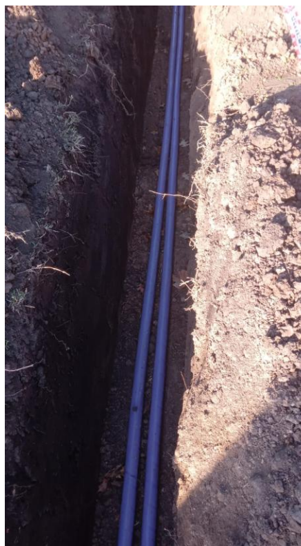
Cableado de baja tensión en una zanja. Esta parte de la red forma parte de la distribución hacia los suministros.
