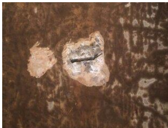
Armaduras expuestas durante la intervención sobre el tanque.
