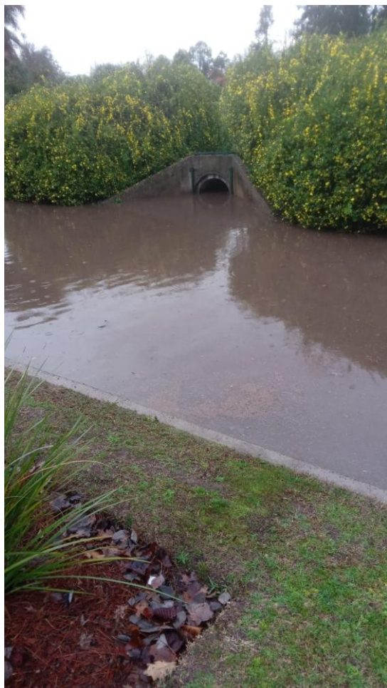
Acumulación de agua junto a la entrada del conducto de desagüe. 2024.
