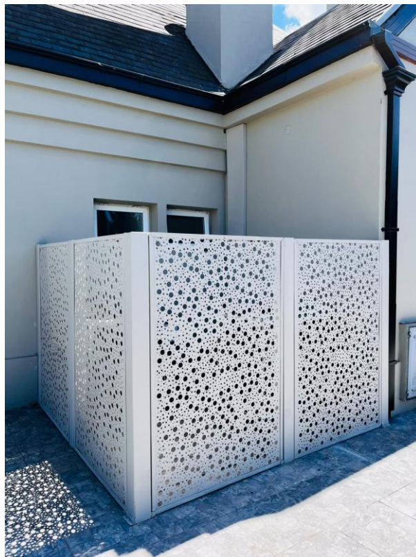
Cerramiento de los equipos exteriores del SUM.
